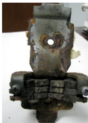
Figure 28 : Corrosion des disjoncteurs
